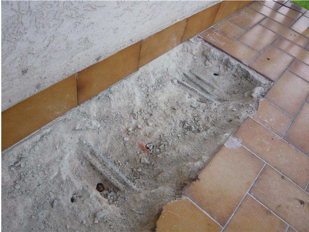
FOTO 10: Balcone est – estradosso: rilievo delle armature (1d14 + 2d12 alternati a 1d14 + 1d12)
