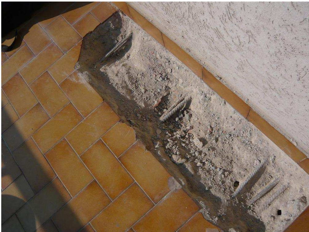
FOTO 11: Balcone est – estradosso: rilievo delle armature (1d14 + 2d12 alternati a 1d14 + 1d12)
