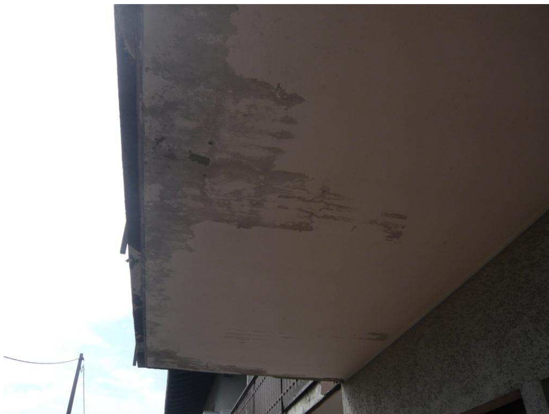
FOTO 4: Balcone est – intradosso: intonaco pericolante
