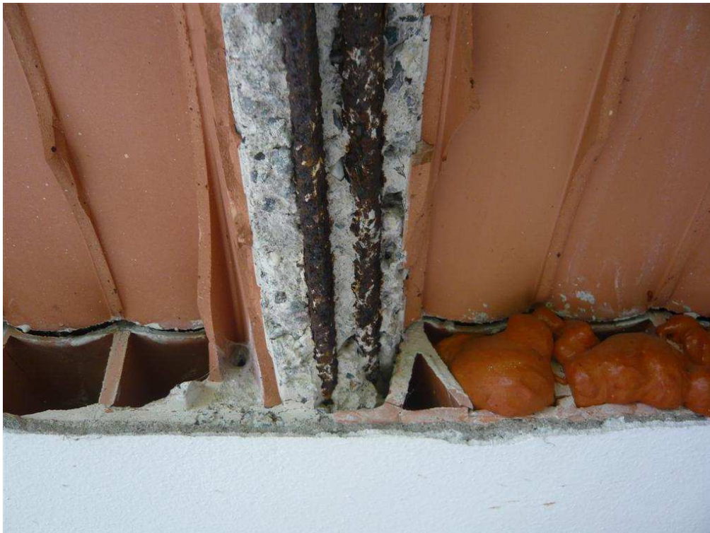
FOTO 9: Balcone ovest – intradosso: armature intradossali, ossidazione
