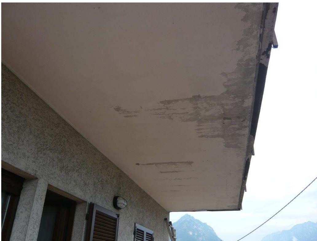
FOTO 3: Balcone est – intradosso: intonaco pericolante
